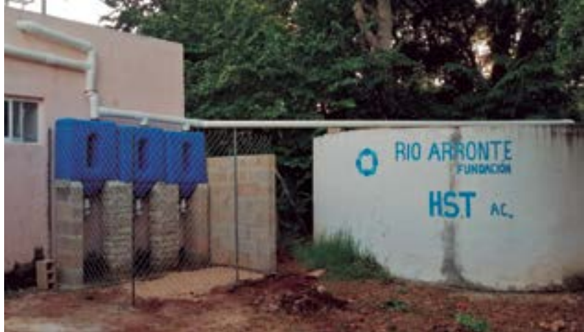
Captadores de agua comunitarios.
